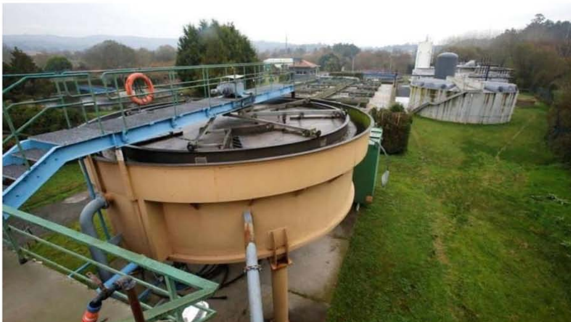
Depuradora de Aguas Residuales de A Silvouta, en Santiago de Compostela. / ECG
